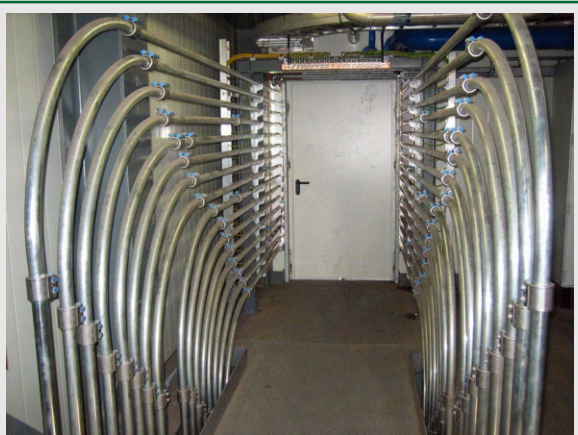
32 пневмопровода к доменным печам
