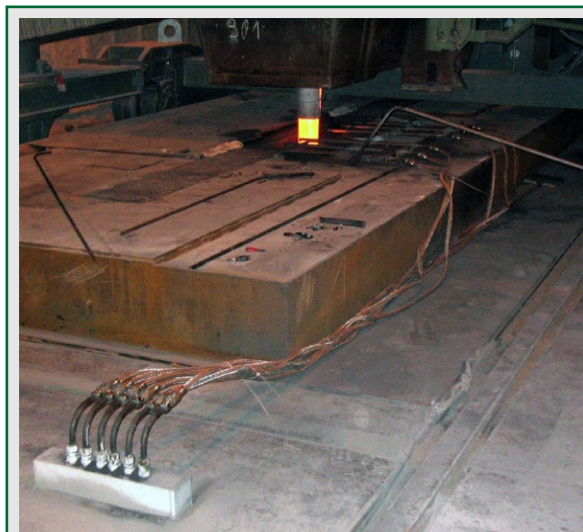
Пневмотрубопроводы к шестиструйному распределителю на установке разлива слэбов
