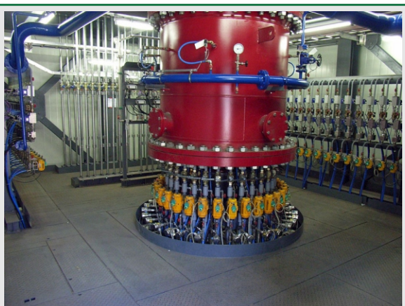
Сосуд-распределитель на 32 пневмопровода
