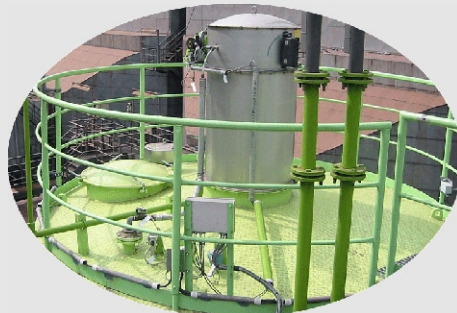
Фильтр на верхней площадке бункера
