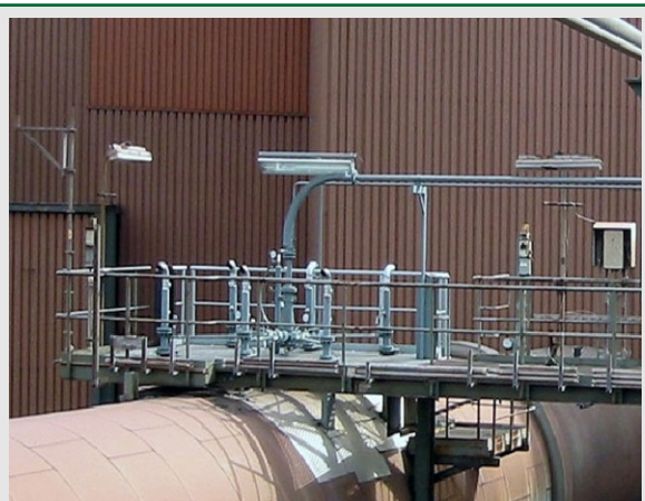
Платформа вдувания на канале отходящих газов
